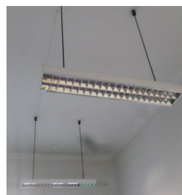
Figura 8.11- Particolare dei corpi illuminanti attualmente installati
