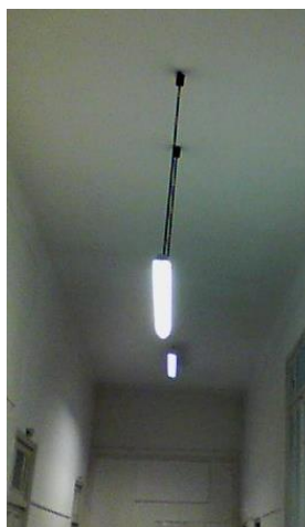
Figura 4.15 - Particolare dei corpi illuminanti installati a soffitto
