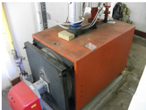
Figura 4.12 - Particolare di caldaia a basemento
