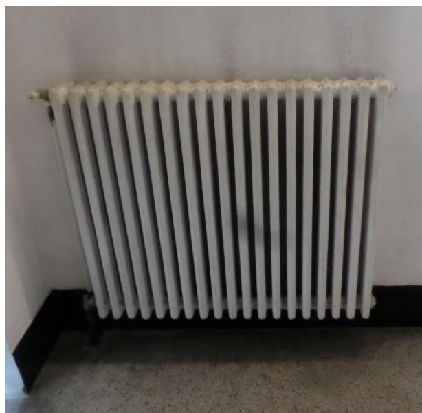
Figura 4.8 – Particolare dei radiatori in ghisa
