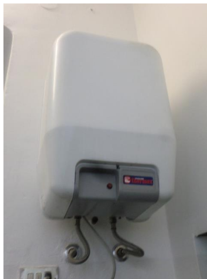
Figura 4.13 - Particolare di un boiler elettrico per la produzione di acqua calda sanitaria
