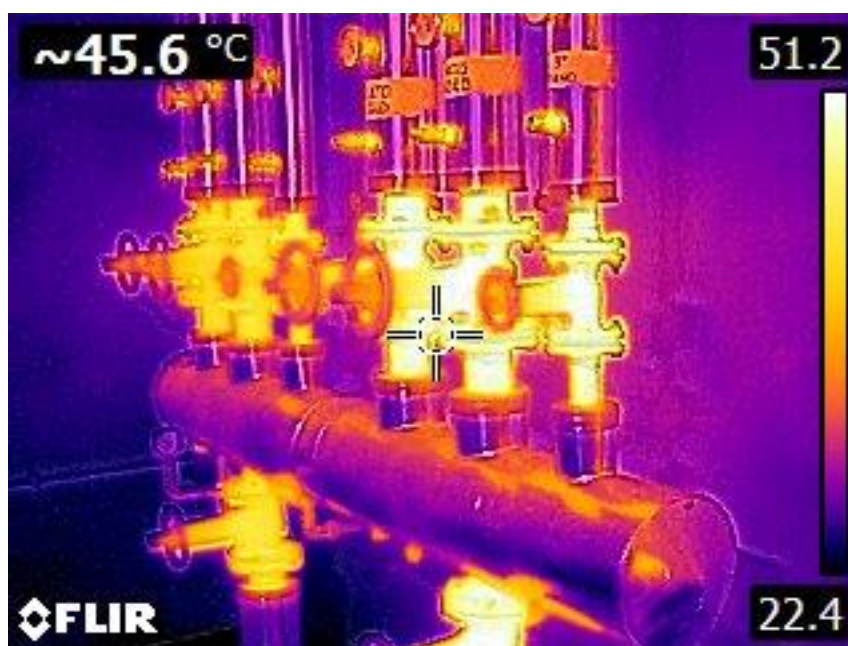
Figura 4.10 – Indagini diagnostiche circuito di MANDATA
