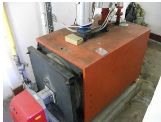
Figura 8.6- Particolare del generatore di calore attualmente installato
