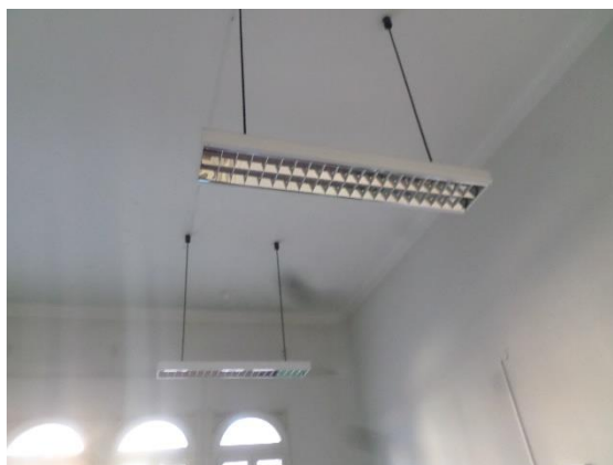
Figura 4.14 - Particolare dei corpi illuminanti ubicati nei corridoi
